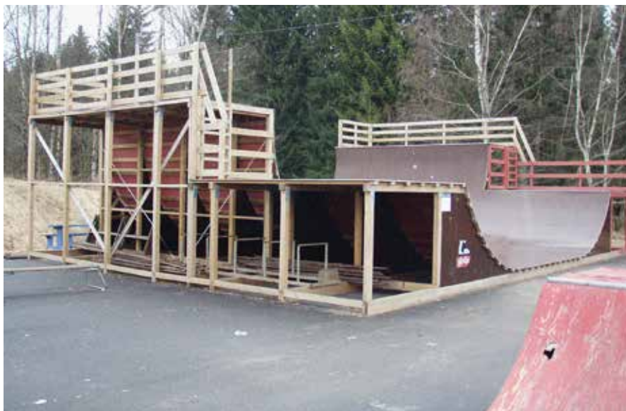
Klatrebar skaterampe med risiko for høye fall ned på asfaltunderlag.
