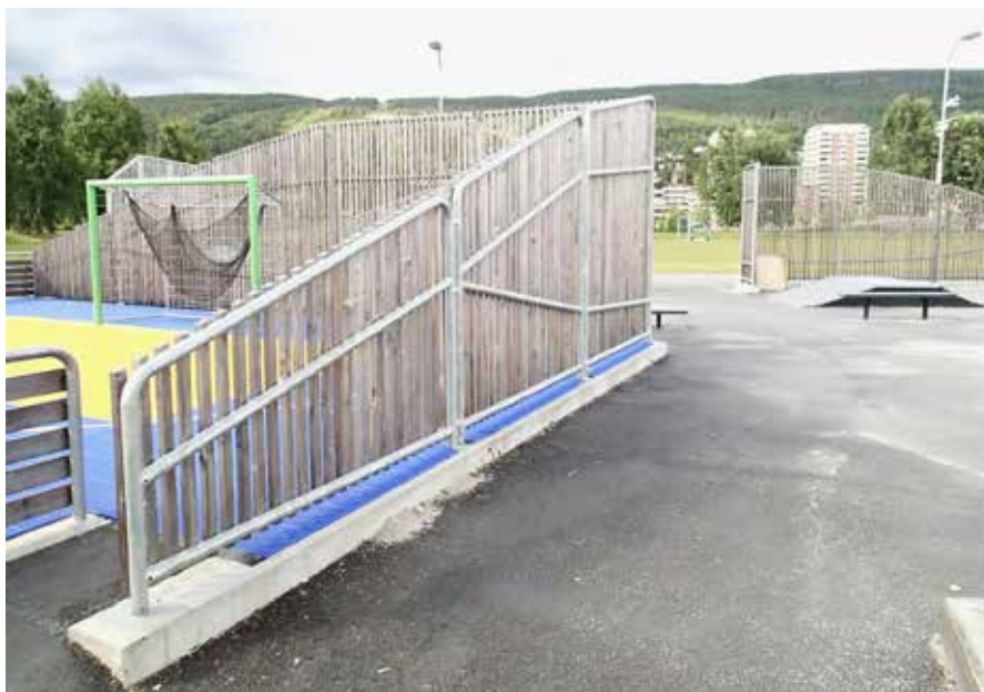
Klatrebar ballbinge med fare for høye fall ned på betongkant og asfaltunderlag.
