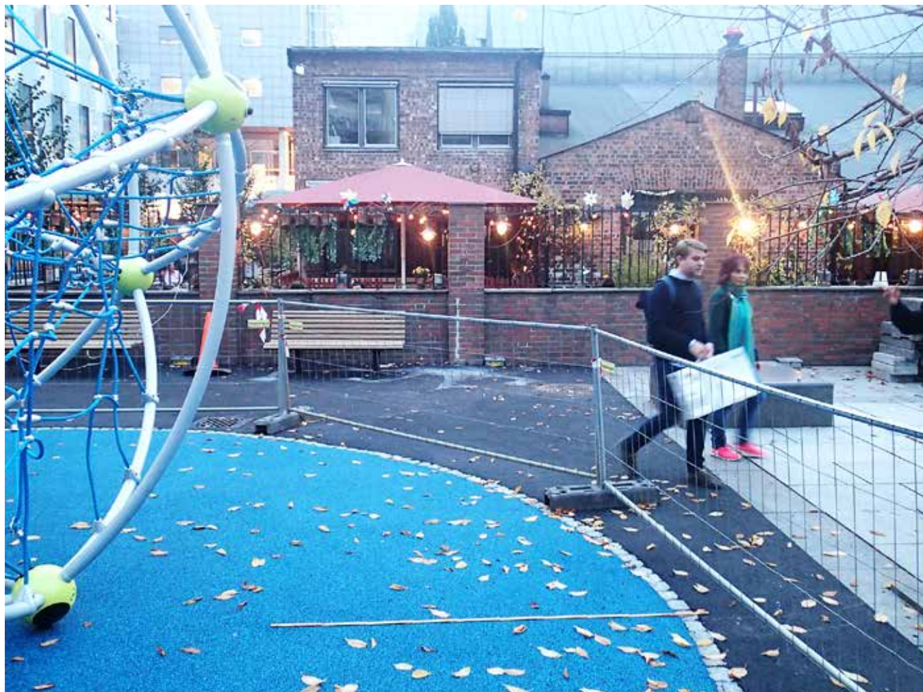
Feilmontert klatretårn med for liten sone og støtflate til stein og asfalt på sidene i forhold til fallhøyden.
